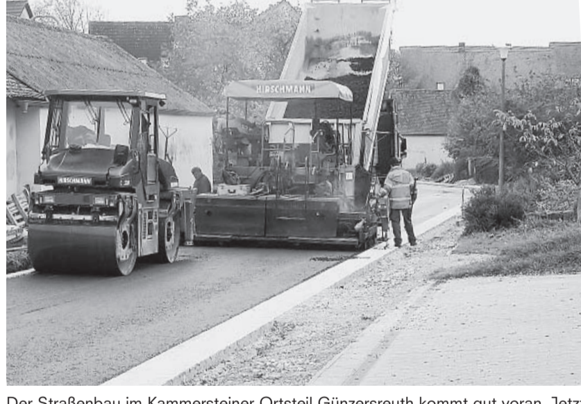
Der Straßenbau im kammersteiner Ortsteil Günzersreuth kommt gut voran. Jetzt wurde in der Chausseehausstraße die Tragschicht eingebaut. Foto: oh
